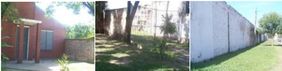
-Encuentro de Sala velatoria 2 con muro perimetral lateral (poco mantenimiento).
