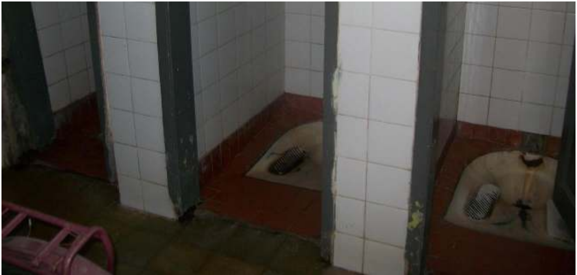
Estado actual de las letrinas.
