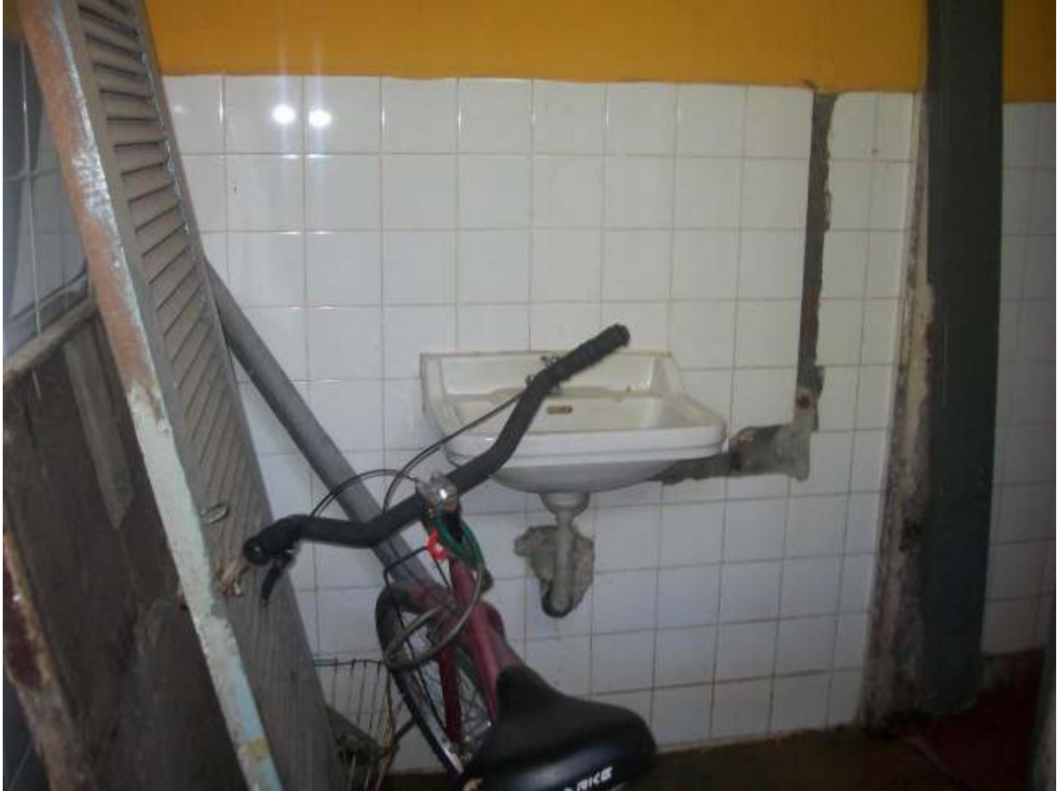
Sanitarios femeninos. Falta de mantenimiento. Sector de guardado de elementos varios.
